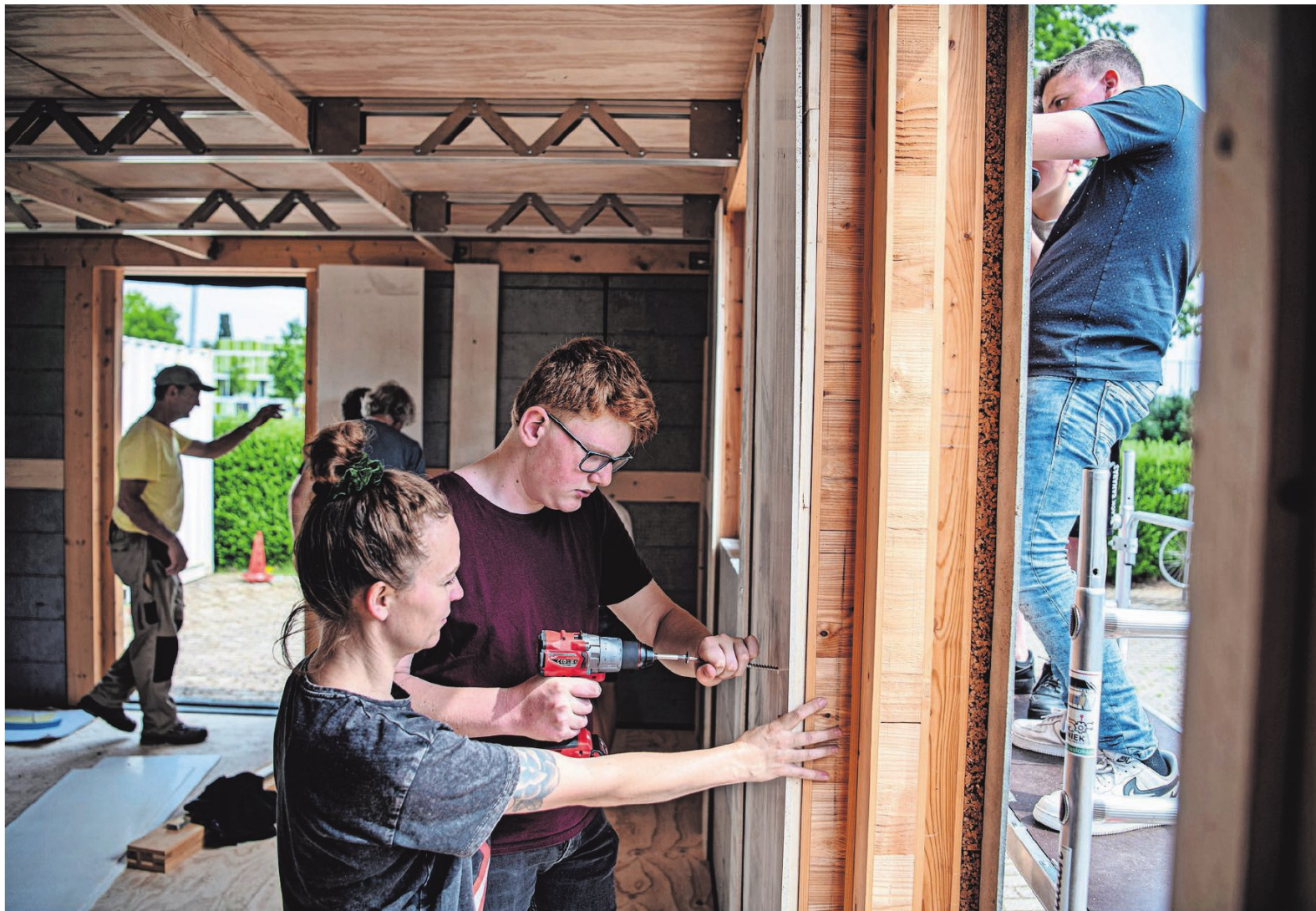
▲ Leerling Thijs van den Beemd draait een schroef in een wand. Rechts op de steiger scholier Bram Beukeboom. FOTO KOEN VERHEIJDEN
